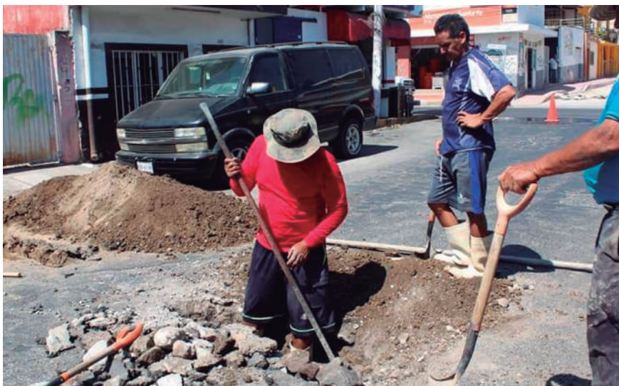
En la reparación de fugas, rompen el pavimento de concreto o asfalto a pico y pala.
