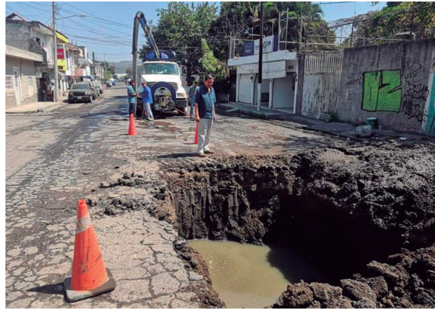
Desazolvando redes de drenaje. Trabajo de alto riesgo al introducirse a las aguas negras.
