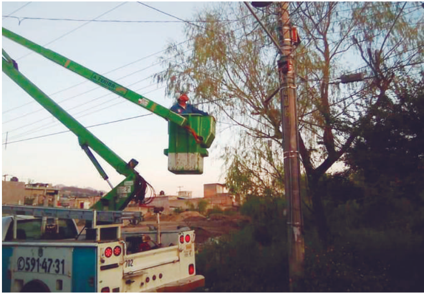
El manejo de las líneas de alta tensión es de altísimo riesgo. Los jefes o usuarios, ¿lo han valorado?
