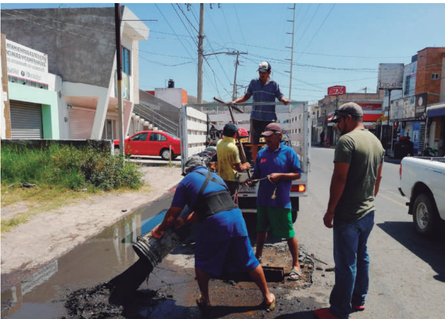
SIAPA Tepic, Los trabajadores realizan sus labores sin el equipo adecuado arriesgando su salud y la de sus familias.
